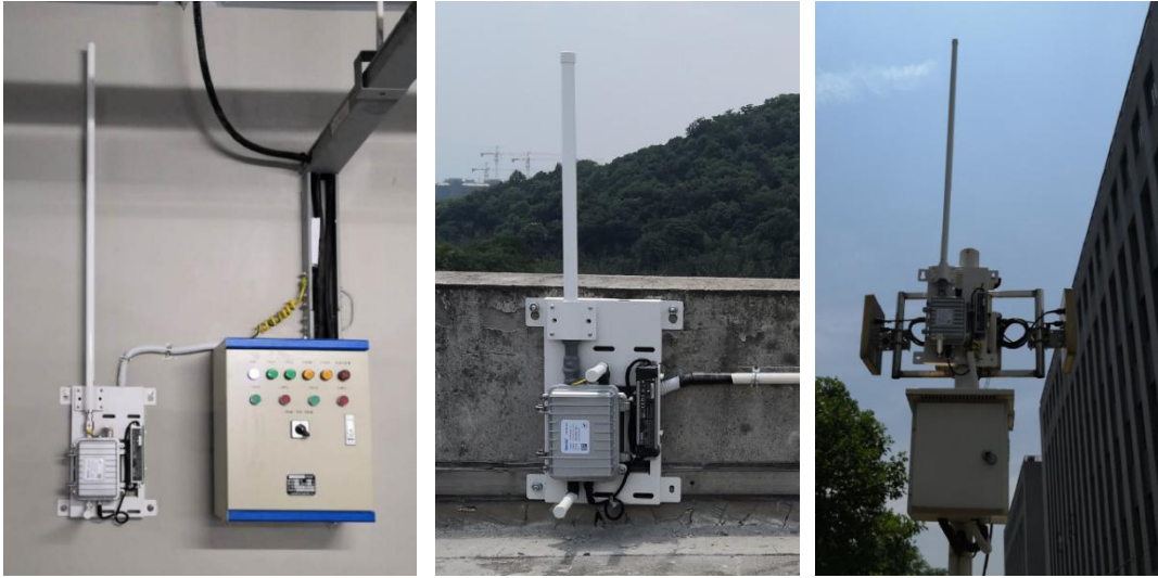
图 6 网关室内、外安装案例
